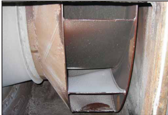
Ash buildup fan
