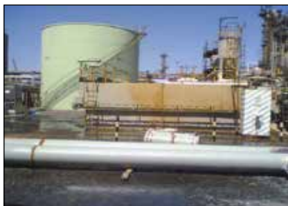
Nádrž v petrochemickém komplexu
