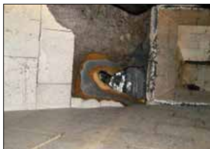
Selhání keramického skluzu po čtyřech měsících před opravou svářením.
