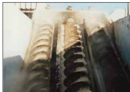
Hubo tres bombas de efluentes en funcionamiento antes de la reparación
