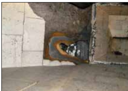
Falla de canaleta revestida por azulejos después de cuatro meses antes del emparchado por soldadura.
